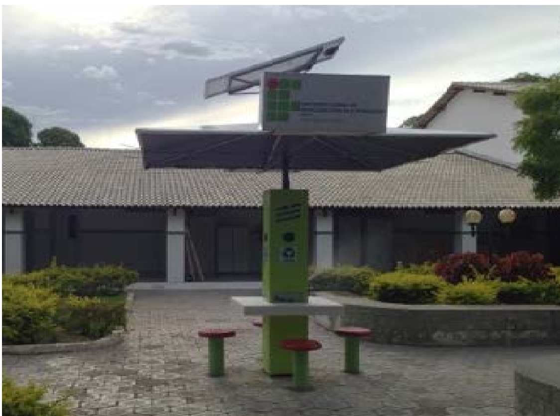
Figura 4. Central de Energia Solar Fotovoltaica, do Instituto Federal de Educação, Ciência e Tecnologia da Bahia (IFBA), Campus Paulo Afonso.
